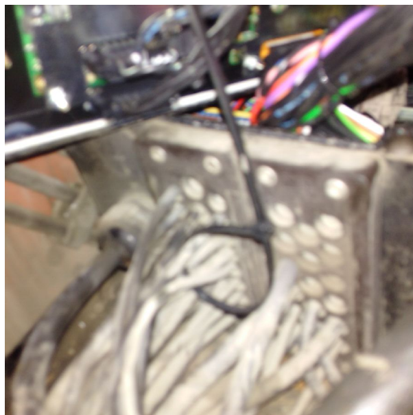
Kuva 2.5: Sähkölaatikosta lähtee isonpuoleinen nippu johtoja.
